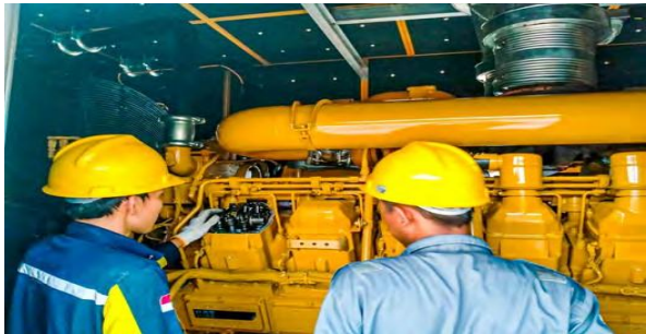
Indokoppel Data Center - Citeureup Preventive Maintenance Caterpillar 2000 & 2500 kVA x 8
