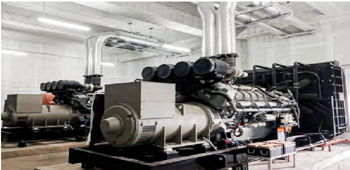
PT Pembangunan Perumahan - Surabaya Timur Hospital Supply & Install (Genset) Austin Power System, Perkins 2250 kVA x 2 Open
